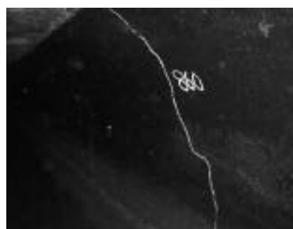
横断ひび割れ全体
