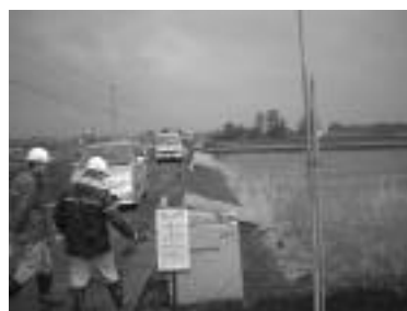
▲ターン農道状況
