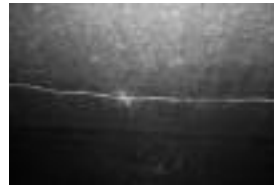
縦断ひび割れ
