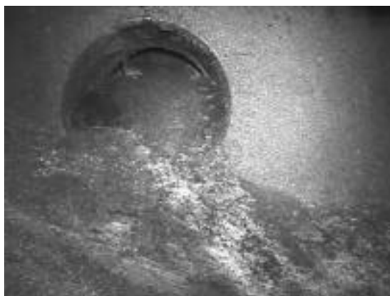
図6 消化液流出管付近の堆積状況 図の消化液排出管の最下部を発酵槽内からの撮影した。 写真奥方向に消化液が出ていく。
