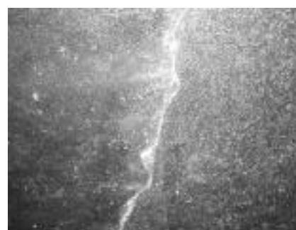
横断ひび割れ
