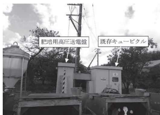
写真-10 電気設備
