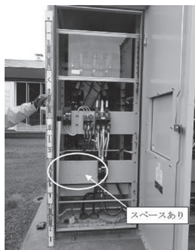
写真-5 キュービクル(左)内部状況
