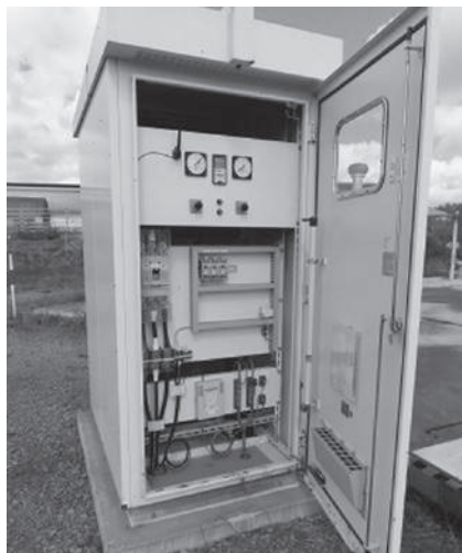
写真-13 肥培用動力変圧器盤内部状況
