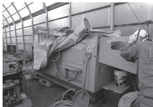
写真-12 非常用自家発電機
