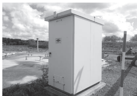
写真-11 肥培用動力変圧器盤
