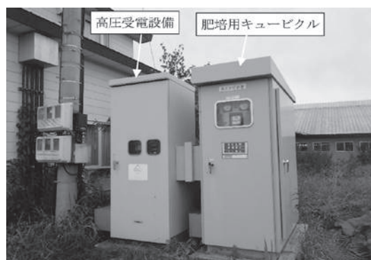
写真-7 電気設備
