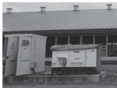
写真-1 配備された非常用発電機
