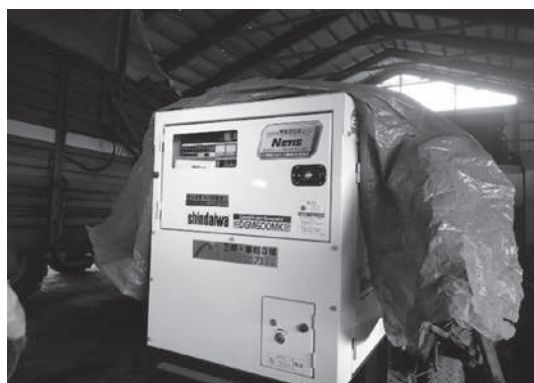
写真-8 非常用自家発電機(可搬仕様)
