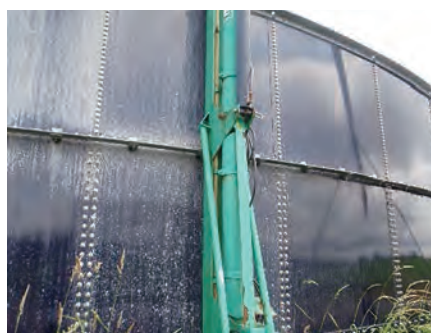
写真ー11 スラリーミキサー本体に発錆
