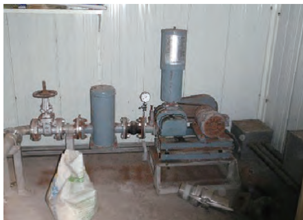
写真－3 曝気装置（ブローポンプ）
