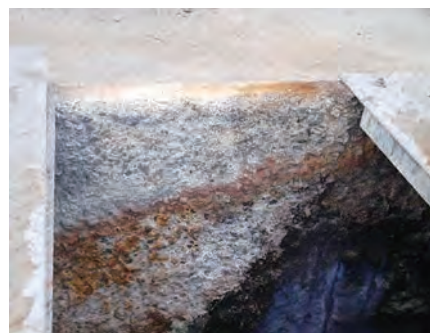
写真ー8 調整槽開口部の骨材露出
