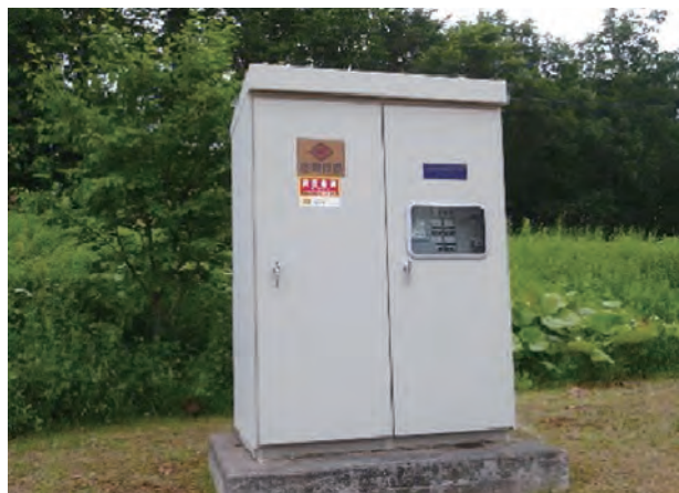
写真－4 動力設備（動力制御盤）
