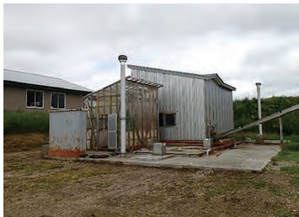
写真－1 流入槽、調整槽
