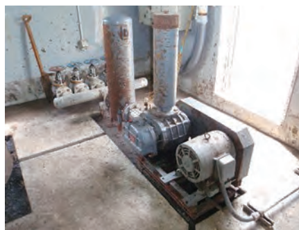
写真ー10 ブロワポンプの全体的な発錆
