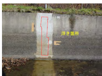
打診による「浮き」部
