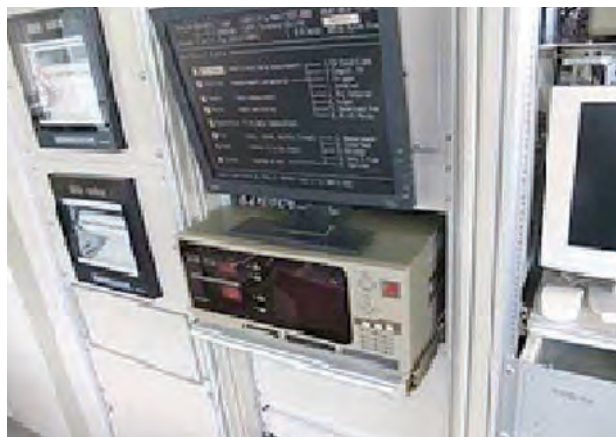
写真-2 故障機器（堤体挙動自動観測装置）
