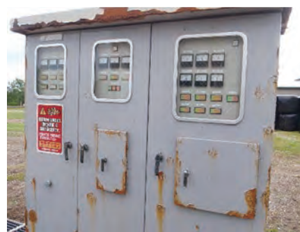
写真ー12 動力制御盤のキャビネットに発錆
