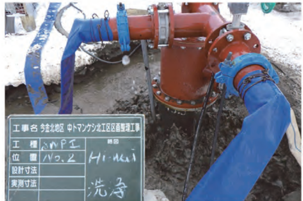
写真－8 揚水ポンプ
