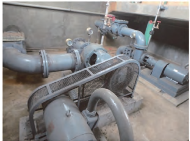
写真-5 ポンプ設備
