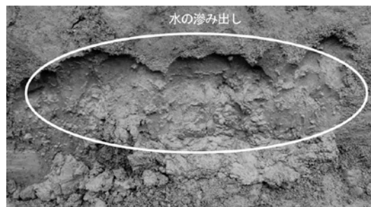
写真-8 地山掘削法面の水のしみ出し
