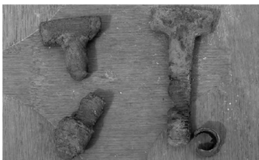
写真-2 離脱防止金具の腐食(例)
