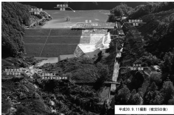
写真-1 厚真ダム被災状況
