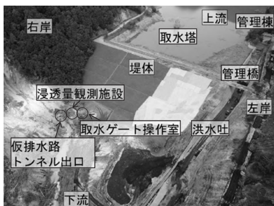
写真-1 厚真ダム堤体被災状況写真
