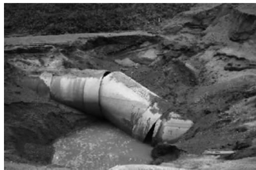
写真-2 管の離脱状況
