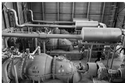
写真-2 漁太排水機場のポンプ
