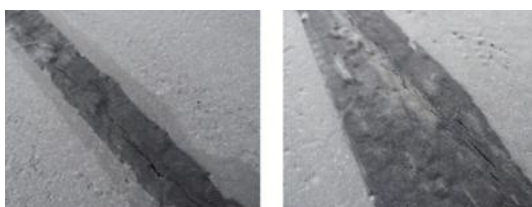
写真-6 クイックスティック(ストレート)-亀裂箇所
