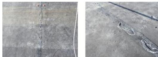
写真-4 RC加熱シーラー（ストレート）-浮き箇所
