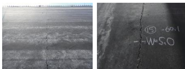
写真-1 ひび割れ調査写真（試験施工前）
