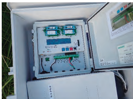
写真-7 遠隔監視装置（本体）
