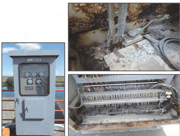
写真－5 電気設備の腐食
