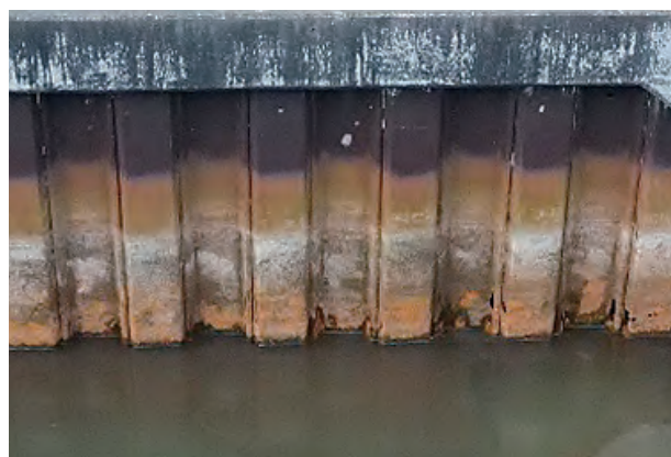
写真－7 鋼矢板の腐食開孔
