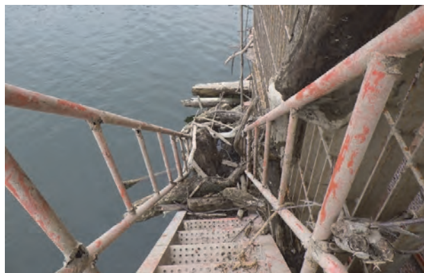
写真-22 取水塔周辺の流木（階段より）
