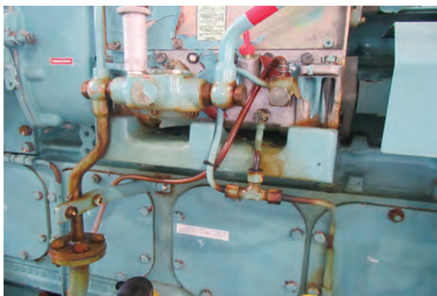
写真－4 主原動機の漏油・始動不良
