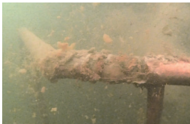
写真－15 階段（手摺り）の塗膜損傷の状態
