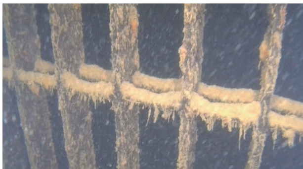
写真-16 階段（手摺り）の浮遊物付着
