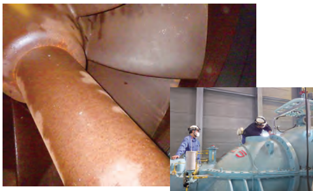
写真－3 主ポンプ内部の発錆・簡易内部診断状況
