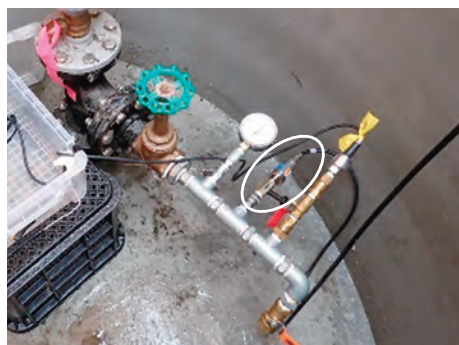
写真-8 遠隔監視装置（水圧計）
