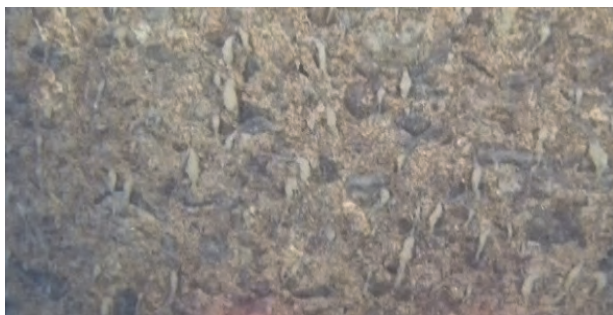
写真－11 粗骨材露出、浮遊物付着の状態（近接）
