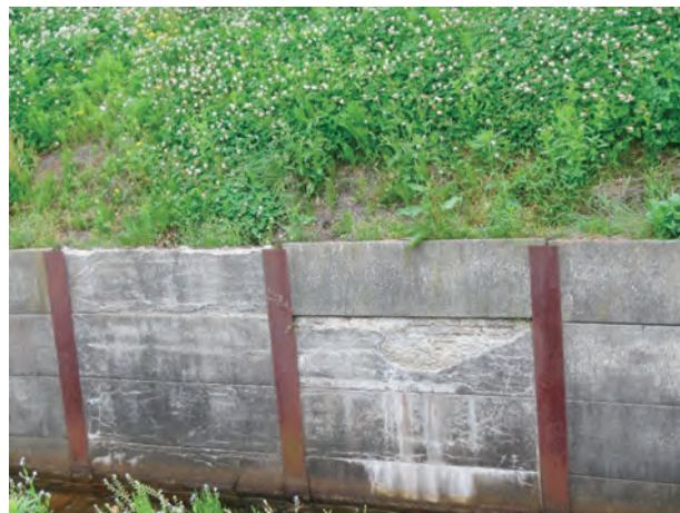
写真－6 コンクリート柵板の経年劣化
