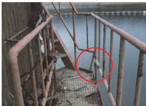
写真－４ 手摺りの破損
