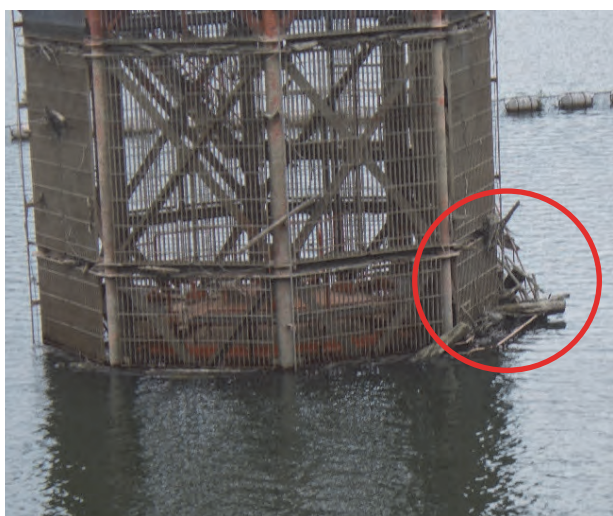
写真-21 取水塔周辺の流木（管理橋より）
