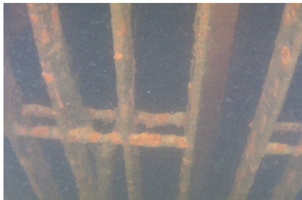
写真－13 スクリーンの腐食
