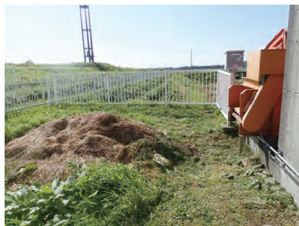
写真-14 塵芥堆積状況
