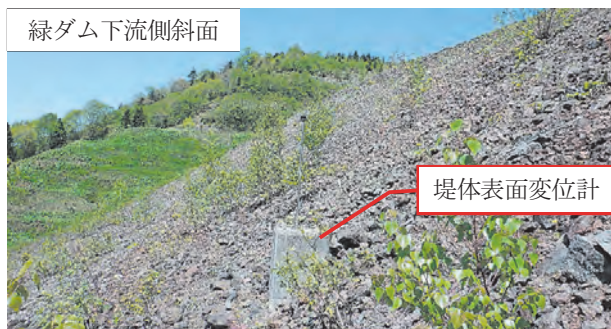
写真－１ 堤体表面変位計
