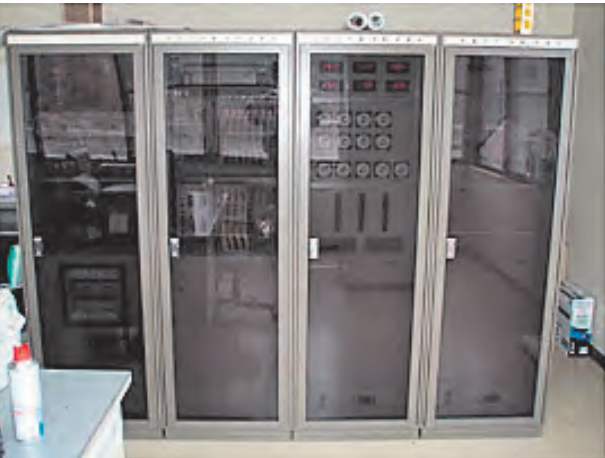
写真－8 データ処理装置
