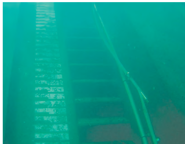
写真－4 管理階段手摺の変形
