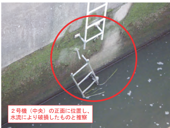
写真-8 吐出し水槽タラップ 破損状況
