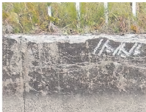
写真－7 B幹線地点4 凍害劣化部の近接撮影
