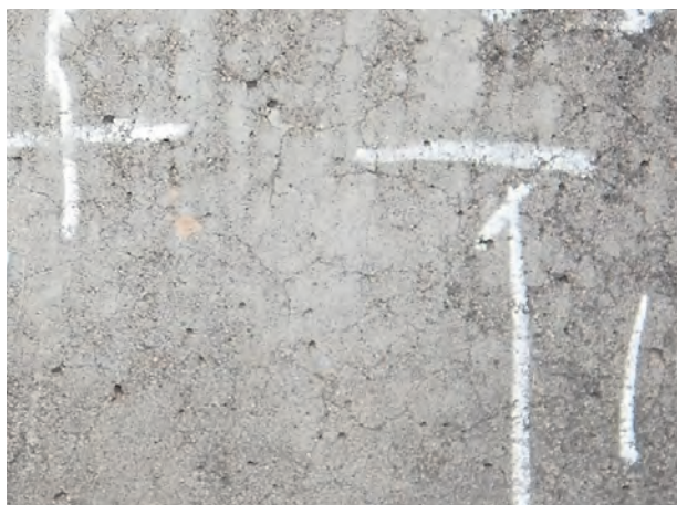
写真－3 A幹線地点1 網目状ひび割れの近接撮影
