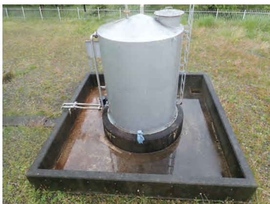
写真－10 鋼製地上タンク（現況機場）
