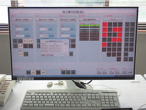
写真－7 管理棟 遠隔操作装置
