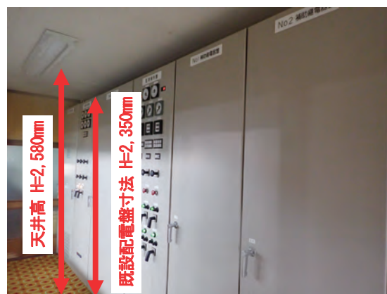
写真－12 操作室天井高と配電盤寸法
