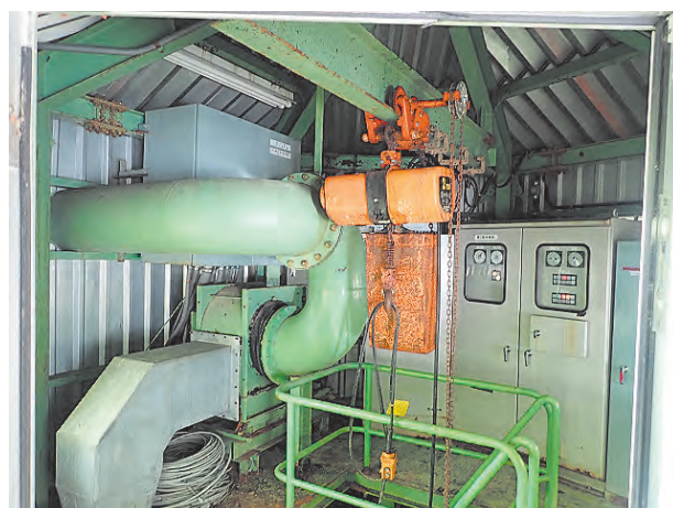
写真－4 第2ゲート室（室内）
